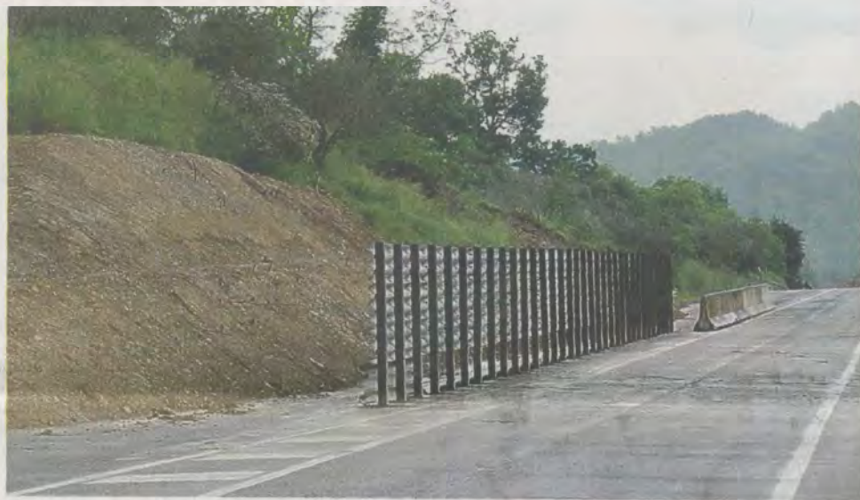
L'area messa in sicurezza lungo la Flaminia dopo la frana di San Giovanni Profiamma
